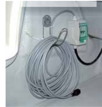
PRISE DE QUAI + DISJONCTEUR
