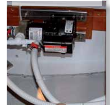
POMPE DE CLIMATISATION
